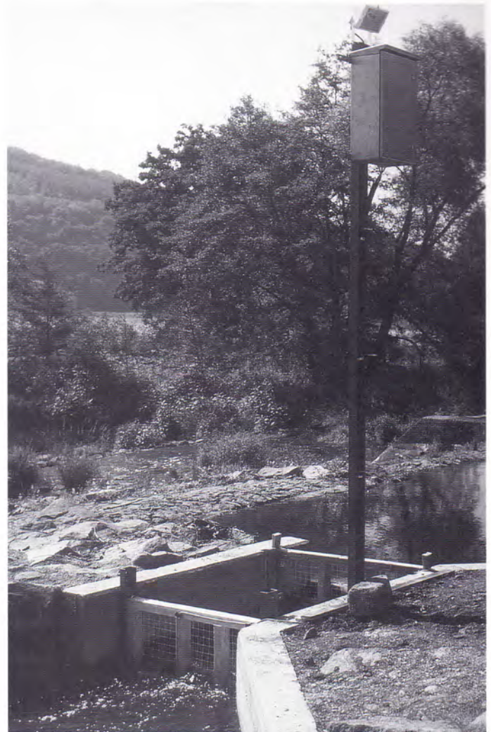
Bild 3: Antennenanlage in Sinn. Die Lesegeräte befinden sich in einem verschließbaren Kasten, der an einem Mast befestigt ist
